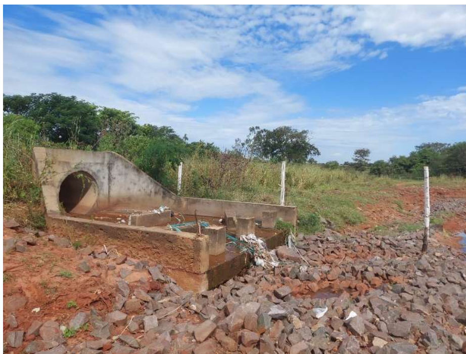
Figura 04 - Rua Mirian Vieira Nardi - ponto mais baixo da bacia de contribuição 04 - Dissipador de águas pluviais existente.
