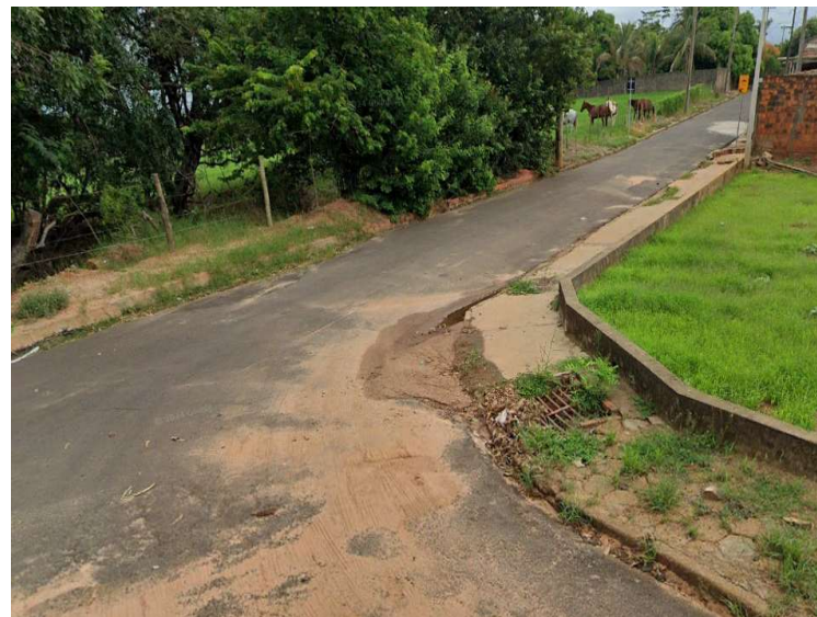
Figura 03 – Rua Mirian Vieira Nardi – ponto mais baixo da bacia de contribuição 04 – onde há ocorrências de alagamentos.
