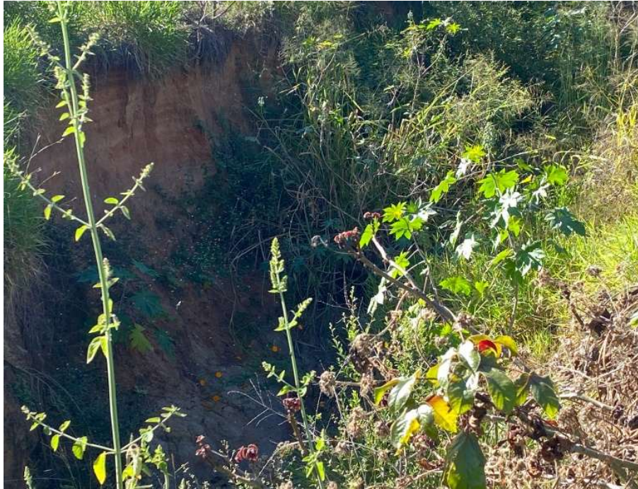
Figura 07 – Rua Mirian Vieira Nardi – ponto mais baixo da bacia de contribuição 04 – Existência de processo erosivo devido a insuficiência do sistema de macrodrenagem
