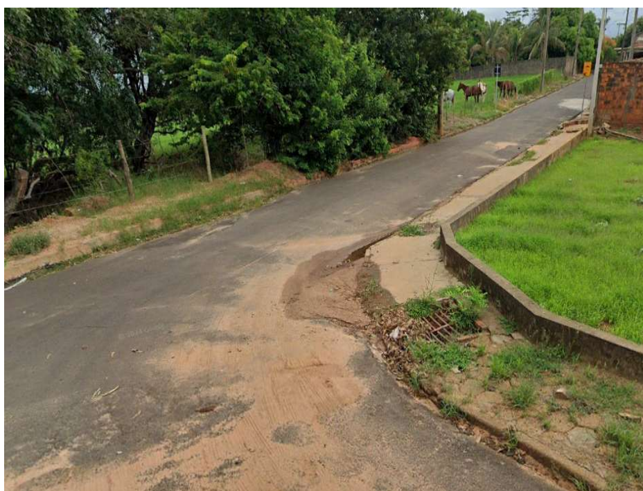
Figura 03 – Rua Mirian Vieira Nardi – ponto mais baixo da bacia de contribuição 04 – onde há ocorrências de alagamentos.
