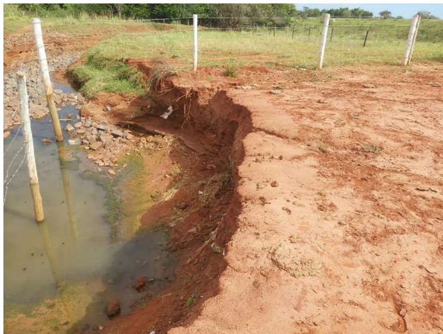
Figura 06 - Rua Mirian Vieira Nardi - ponto mais baixo da bacia de contribuição 04 - Existência de processo erosivo devido a insuficiência do sistema de macrodrenagem
