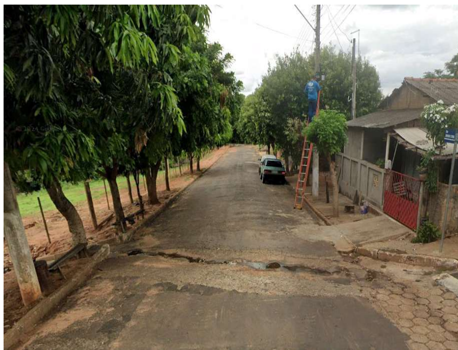
Figura 02 – Rua Mirian Vieira Nardi – ponto mais baixo da bacia de contribuição 04 – onde há ocorrências de alagamentos.
